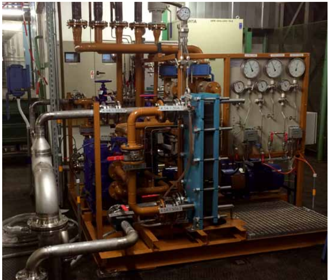
Skutečná instalace sou- pravy v elektrárně
